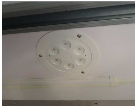
Versenkte LED Innenbeleuchtung
